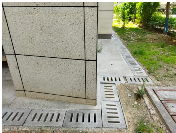
一区排水明沟（2025.5）
