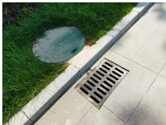
雨水口+雨水井（2025.5）
