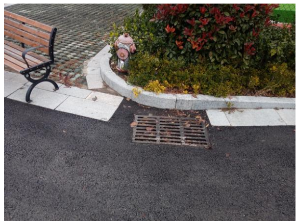
项目区内雨水口现状（2024.12）
