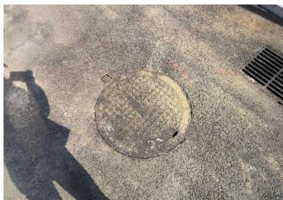
项目区雨水井
