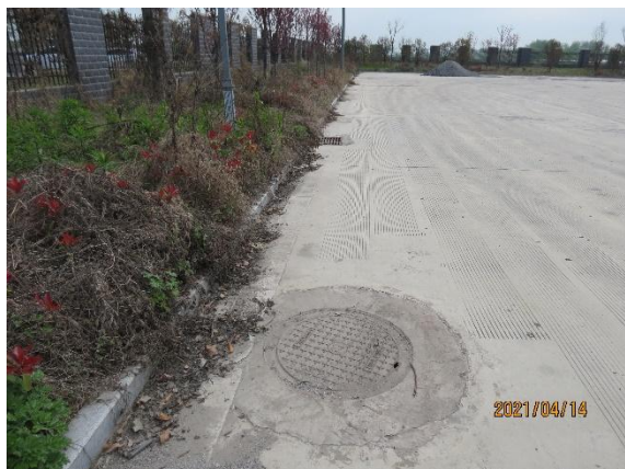
管护设施区雨水井
