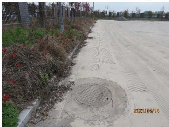
管护设施区雨水井
