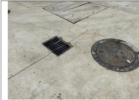
雨水口+雨水井
