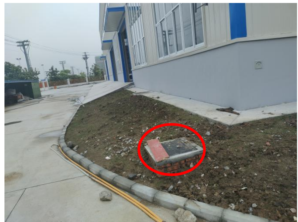
厂区已实施的雨水井
