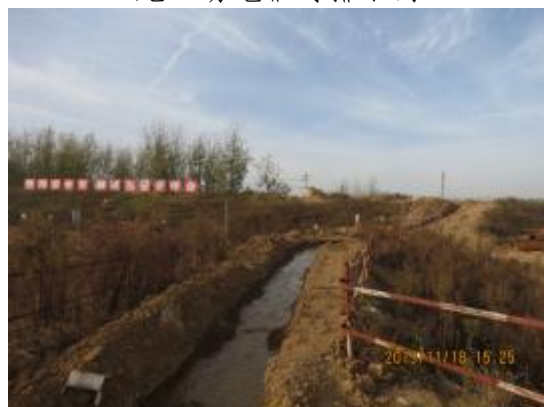
临时堆土场排水沟
