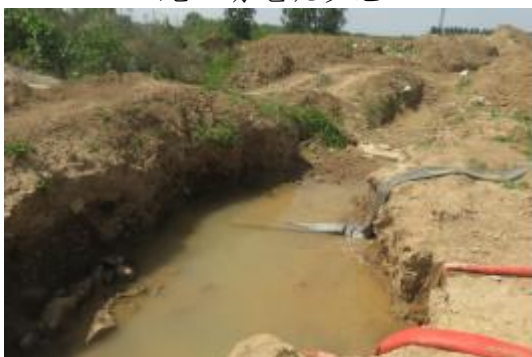
临时堆土场沉沙池
