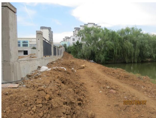
项目区南侧红线外施工扰动现状
