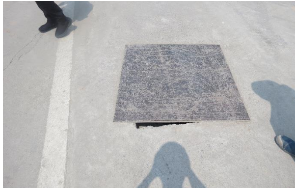
主体工程区雨水管道排水
