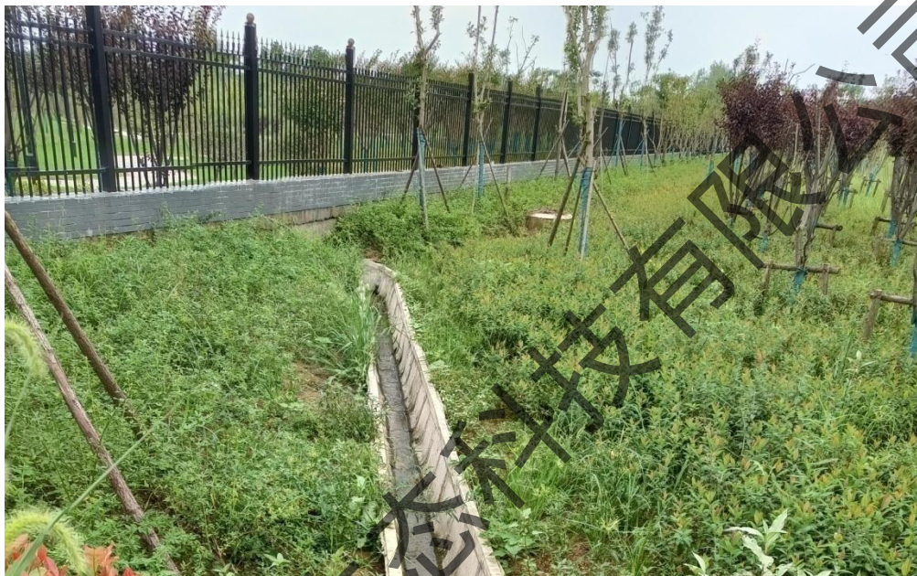
图 1.6 砼预制块排水沟现状图
