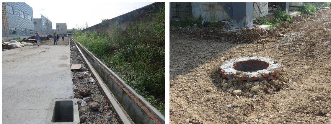
厂区排水明沟、雨水口
